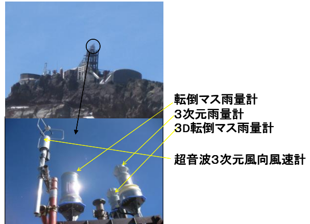
写真1 転倒ます雨量計と3次元風向風速計等
