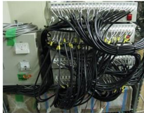
写真2、充放電切り替え装置と自動充電器
