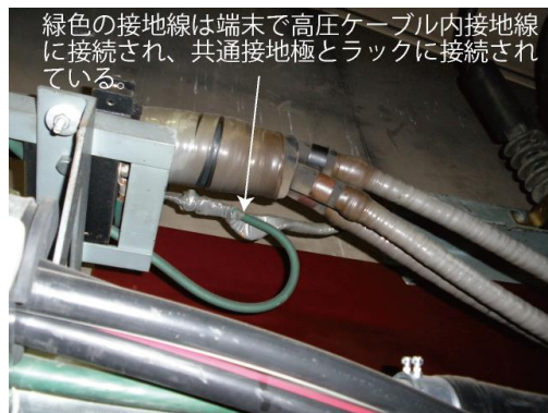
図1 高圧ケーブル端末処理部分 ラックには建物導電構造体と電氣的接続は無い。
