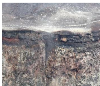
図5 山頂北側火口壁の崩壊
