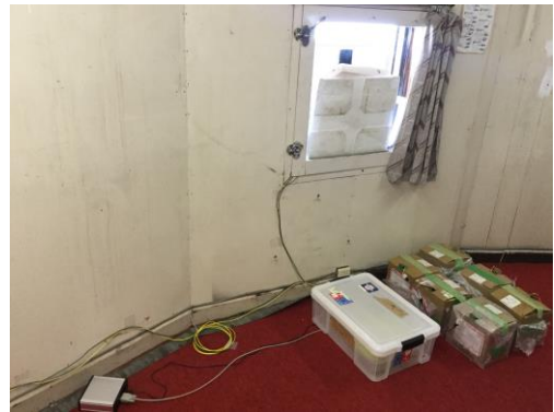
図 1 Fuji-sat3 の設置状況。1 号庁舎 2 階。
