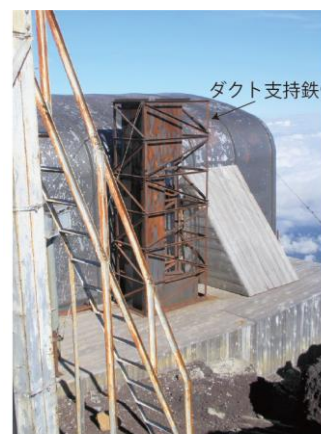
図8 回転球体法適用受雷個所等で等電位強化必要箇所と考えられるダクト支持鉄骨
